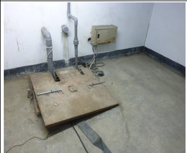
雨水再生水利用-閥基
