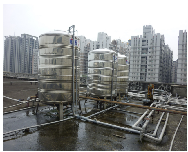
雨水再生水利用貯水塔
